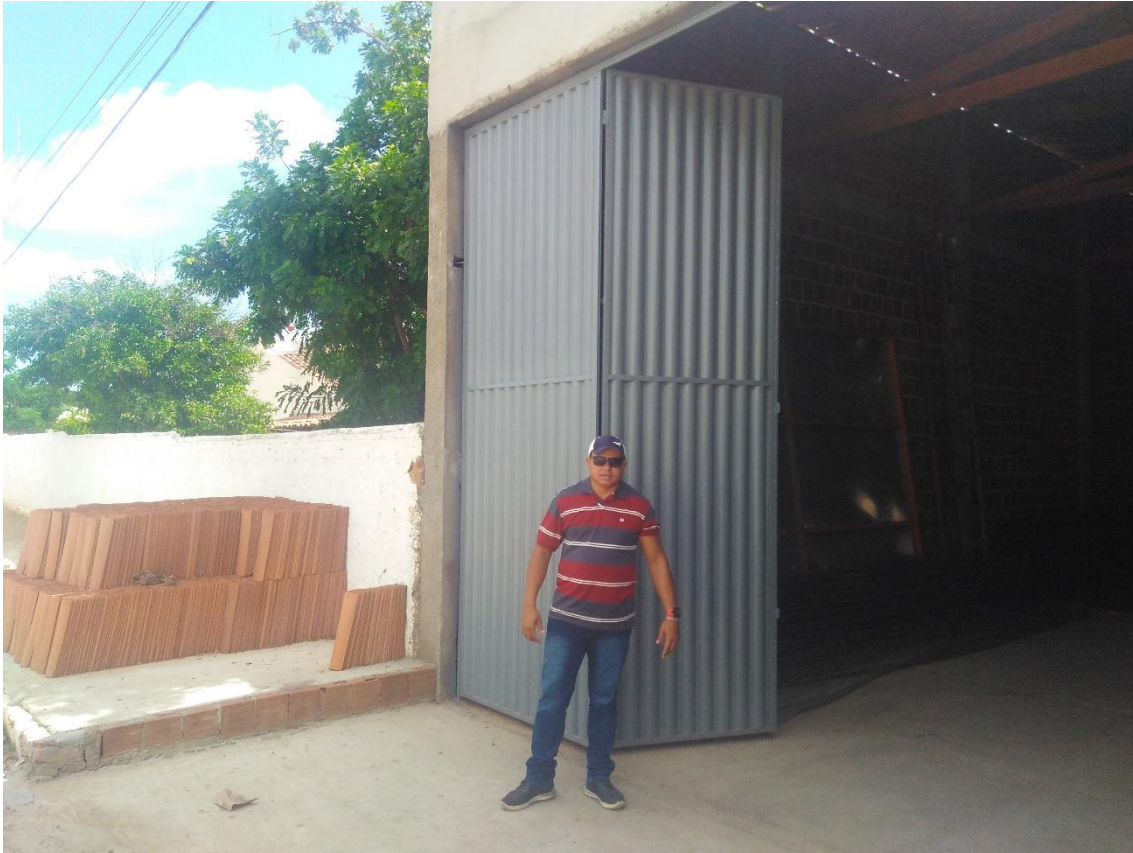
GALPÃO DA EMPRESA EM REFORMA LP CONSTRUTORA E LOCADORA DE MÁQUINASEIRELI - EPP, CNPJ: 17.278993/0001-60
